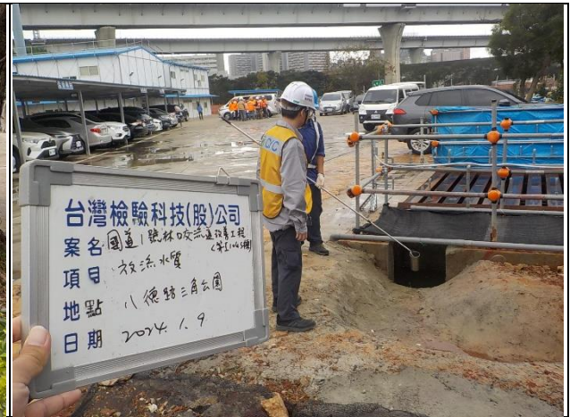
監測項目：放流水質 監測日期：2024.01.09 監測地點：八德路三角公園
